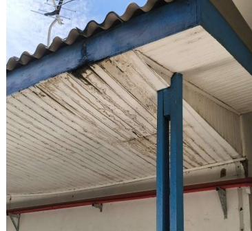
Figura 7 - Beiral com forro danificado e sinais de goteiras
