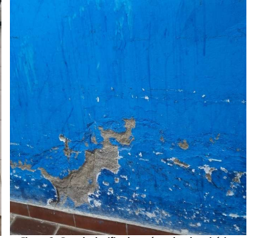
Figura 6 - Parede danificada na área dos dormitórios
