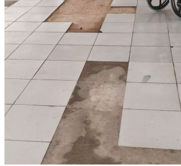
Figura 5 - Piso danificado área de convivência
